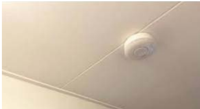
Rookmelder op elke bouwlaag
