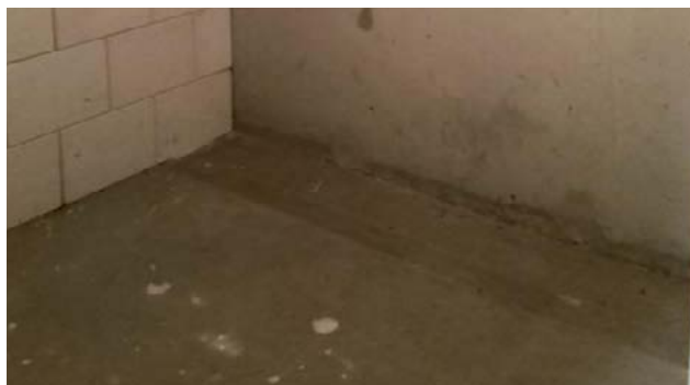
Geen vloerafwerking aanwezig
