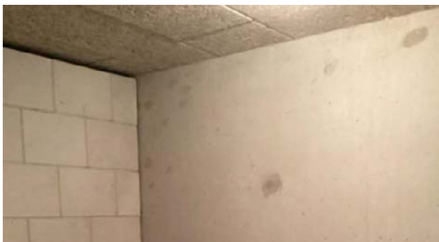
Geen muur- en plafondafwerking
